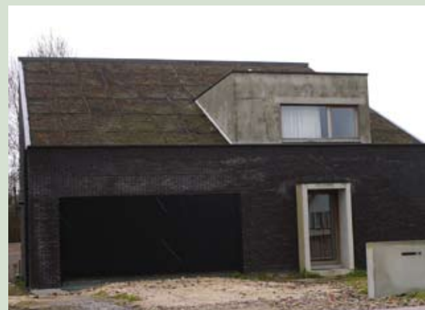
schade hellend dak
